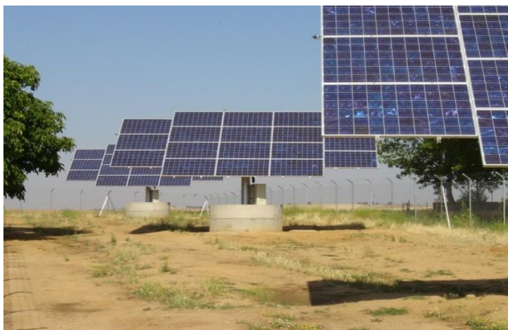
Cabaña la Mota: 11,448 kWp
