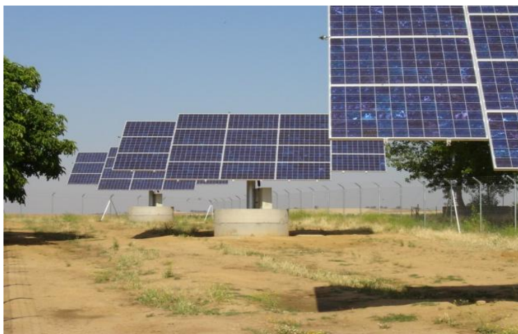
Cabaña la Mota: 11,448 kWp
