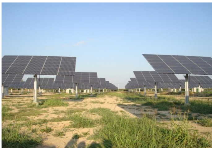
Picanda Solar: 110,7 kWp
