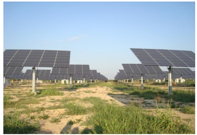
Picanda Solar: 110,7 kWp
